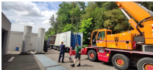
Anlieferung der atb-Pilotanlage im Buchenbachtal, Sommer 2024
