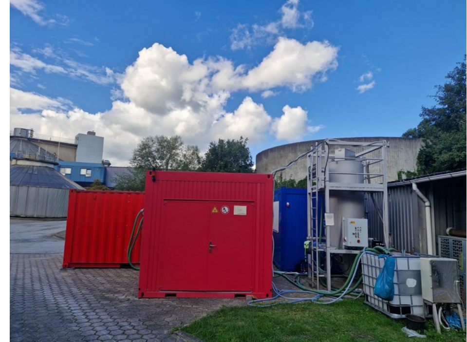
Betrieb der Pilotanlagen auf dem Gelände KA Ahrensburg (Foto: T. Wehnke, THL, Projekt WieBe4-SH, 09.09.2026)
