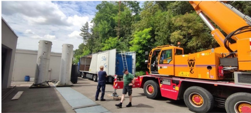
Anlieferung der atb-Pilotanlage im Buchenbachtal, Sommer 2024
